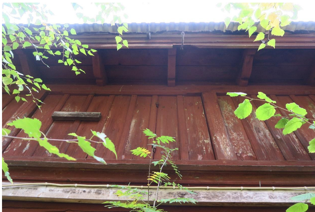
Profilerade takestolstassar samt spår av luckor ut mot gården. Gångjärnen kan ses i bild.
