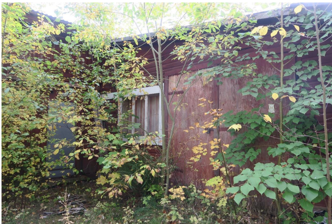
Den låga tillbyggnaden med garagedel i söder är kraftigt övervuxen med sly.
