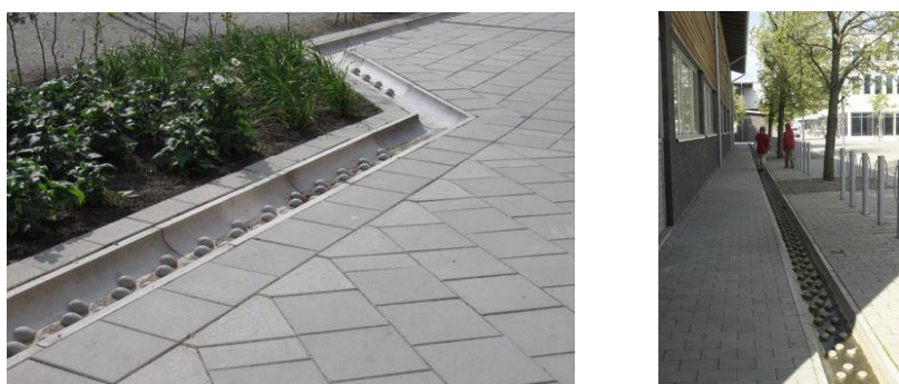
Figur 30. Exempel på dagvattenrännor. (Foto: S: Eriks, 2017)
